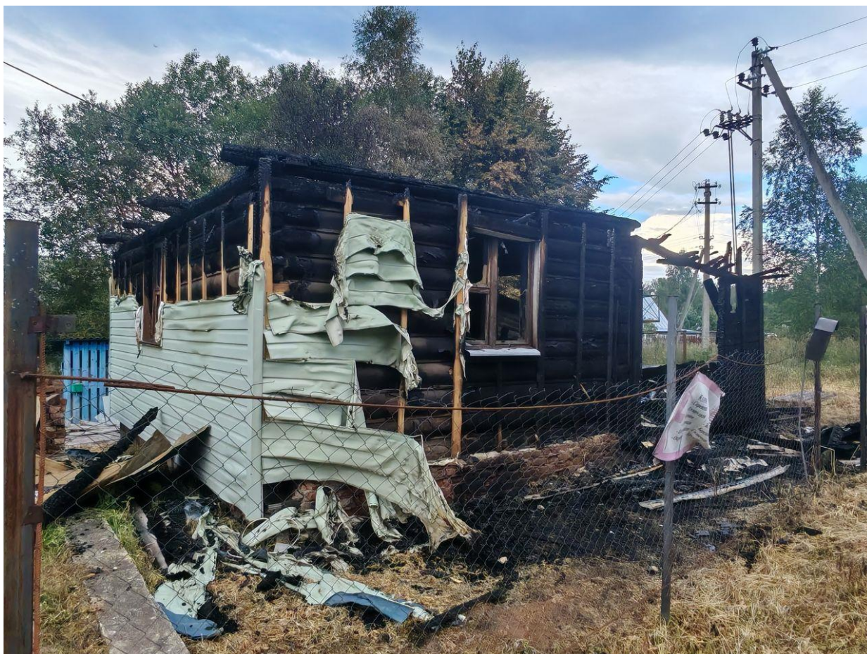
Приложение к Акту обследования здания Правления ТСН «Ветеран», поврежденного пожаром 06.08.2025г.
